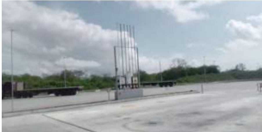
Figura 7-68, Sistema de Venteo instalado en los tanques de almacenamiento de combustible
