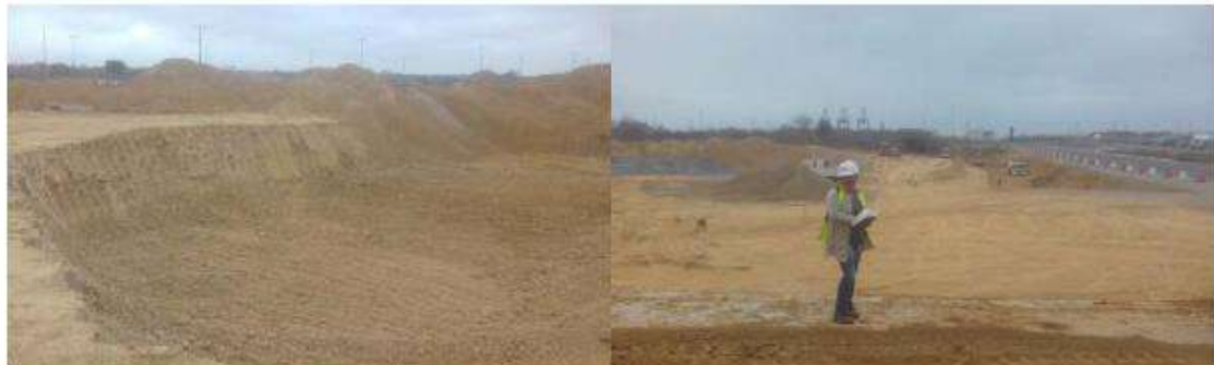
Foto 3-vista de las excavaciones, en la parte central del área, observación de las capas inferiores
