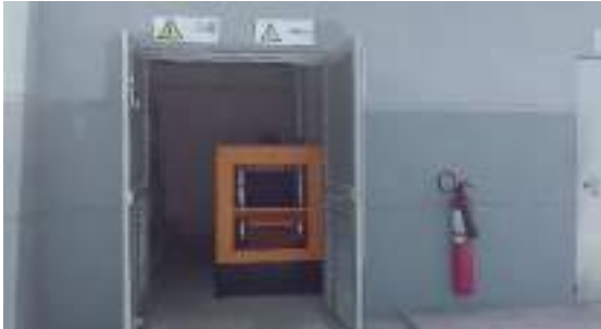
Figura 7-30, Cuarto de Generador
