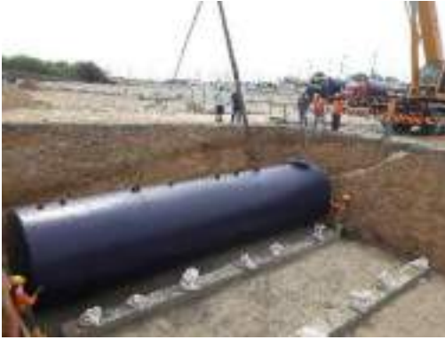
Figura 7-61, Anclaje de tanque de combustible
